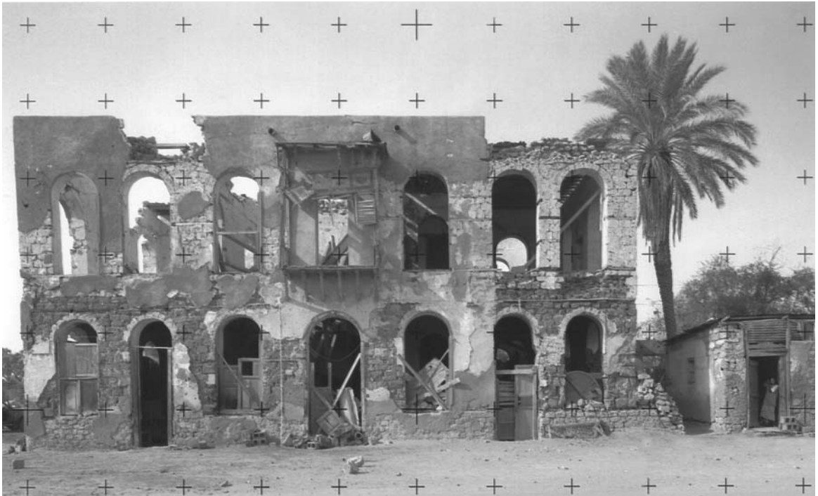
Abb. 11. Massawa: Messbild eines stark beschädigten Eckhauses (Block 139).
